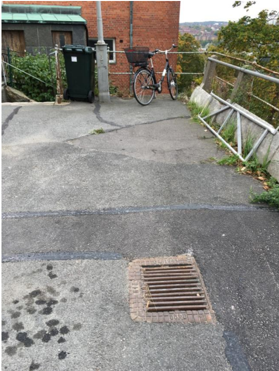
Figur 6. (ovan) Rännstensbrunn vid fastighet Gårda 33:1. Avrinningsområde för rännstensbrunnen är öster ifrån.
